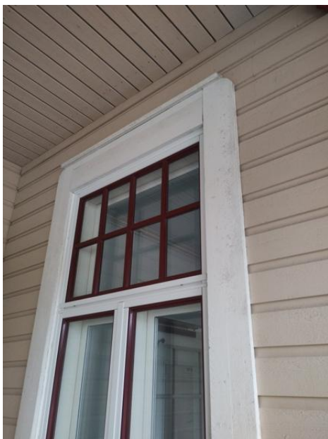
Ikkuna homepesun jälkeen. Ennen maalausta vielä levitetty homeentappaja-liuos pitkävaikutteisena.
