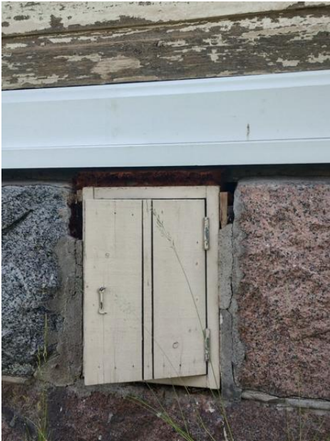
Osa tuuletusluukuista uusittu aiemmin. Ei vaadi maalinpoistoa.
