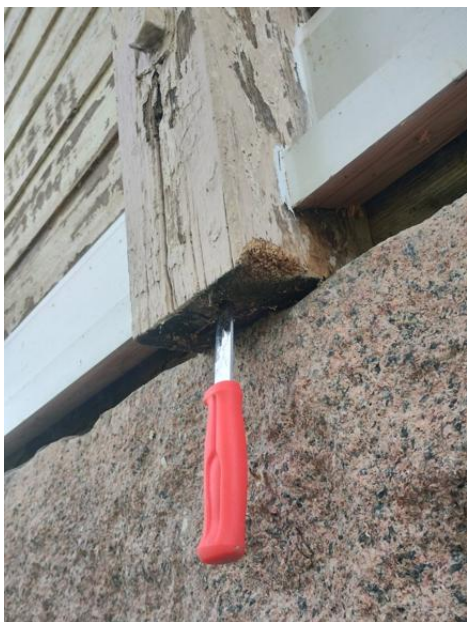
Pystypalkeissa paikoin lahoja kohtia.
