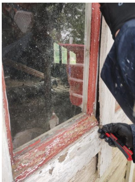
Vanhat yläikkunat paikoin huonossa kunnossa ja heikosti kiinnitettynä.
