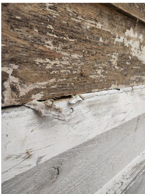
Akryylimassaa saumoissa. Korvataan pellavaöljykitillä.
