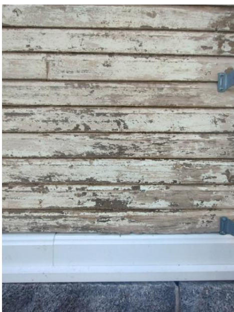
Seinäpintaa ensimmäisen maalinpoiston jälkeen.
