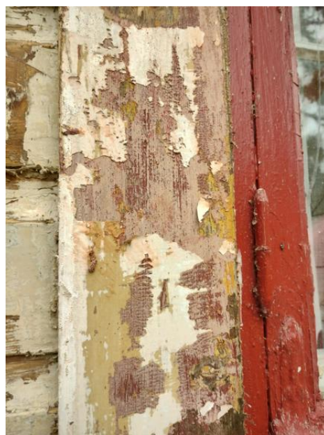
Vanhoja maalikerrostumia päärakennuksen ikkunanpielilautoissa.
