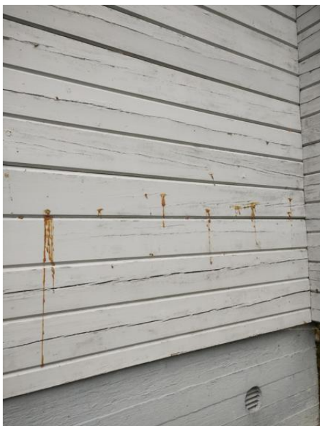
Runsaasti pihkavalumia auringon puoleisella seinillä.
