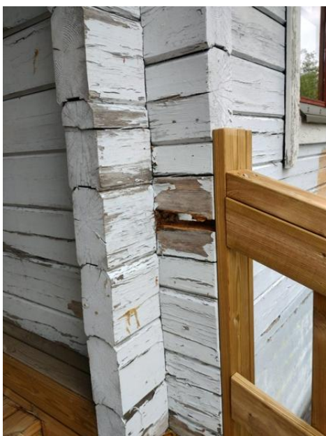
Lahovaurio saunan kulmalla portaikon kohdalla.
