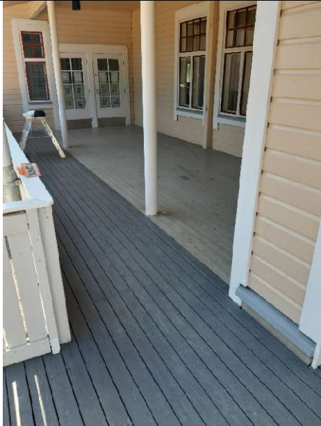
Sisäänkäynnin kuistiosa lattia käsittelemättä.
