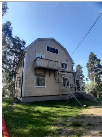
Ikkunan ylälauta lahonnut
