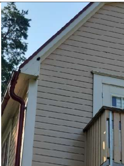
Tikka hakannut kolon , tämä korjataan
